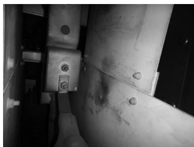
图 1 开关柜母排对绝缘隔板放电
